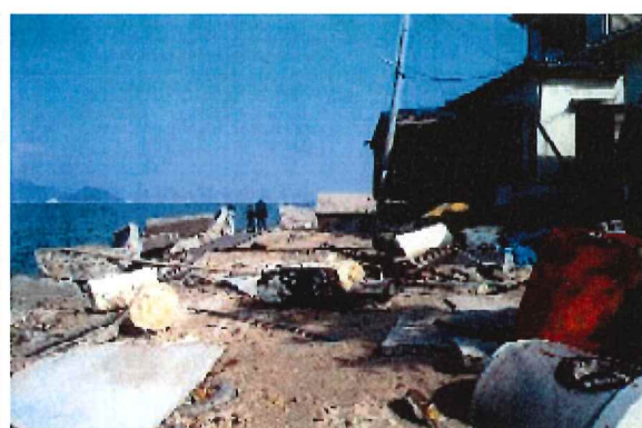
高潮により損壊した護岸（呉市）
