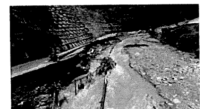
氾濫により損壊した黒川流域の道路（2017年7月8日、福岡県朝倉市）
