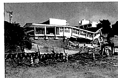
桂川の増水により一部が崩落した朝倉市立比良松中学校の校舎 (2017年7月13日、朝倉市宮野)
